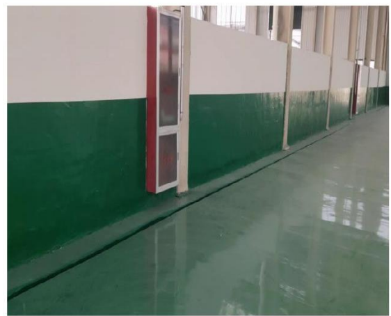
废电解液收集导流沟
