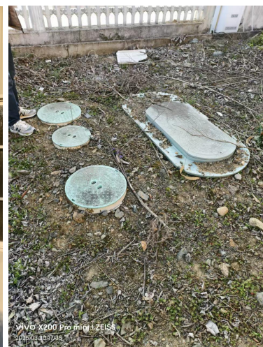
地埋式污水处理站
