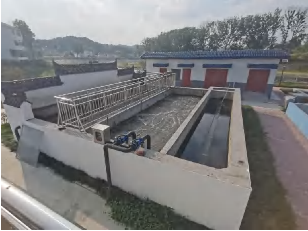
铁铺镇污水站
