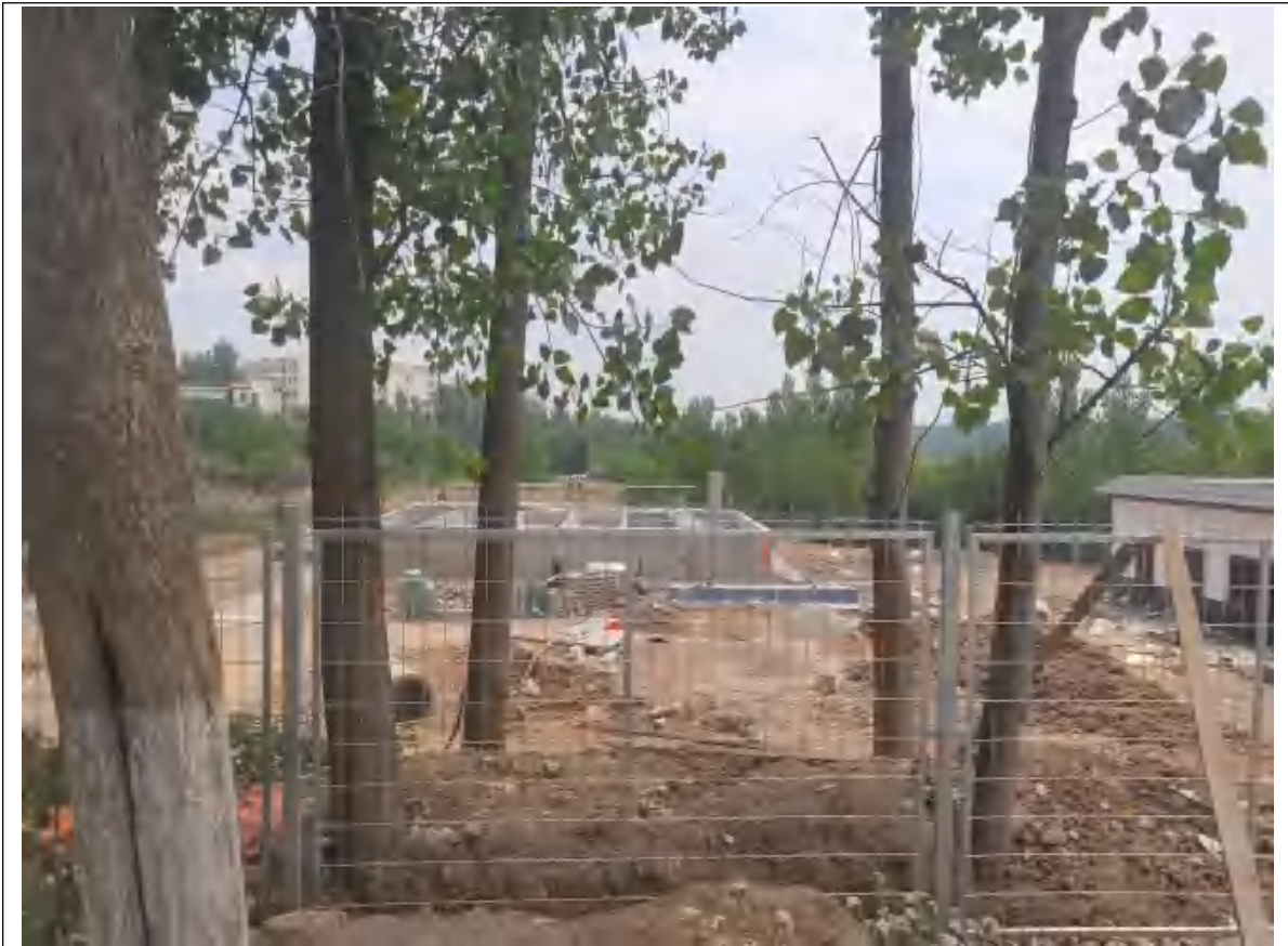
楠杆镇污水站 2 号现状
