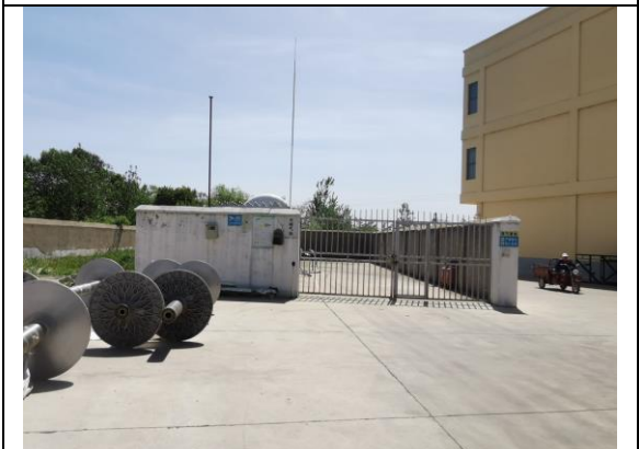
南侧的天然气管站
