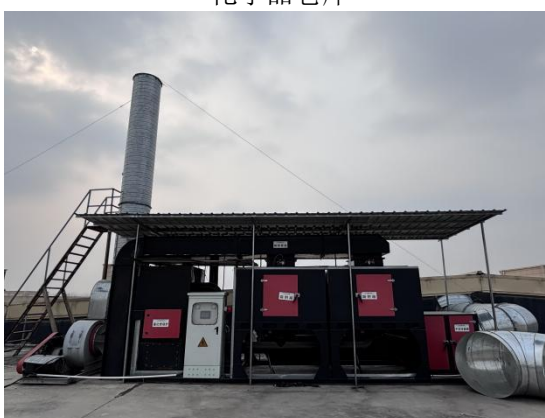
现有环保设备（干式过滤+活性炭吸附+催化燃烧）
