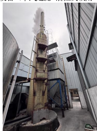
锅炉配套环保设备
