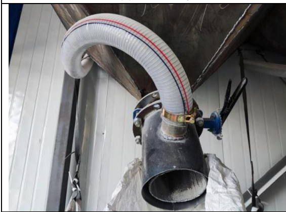
下料口负压集尘设施
