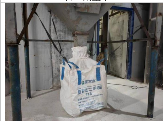
封闭式除尘器卸灰口
