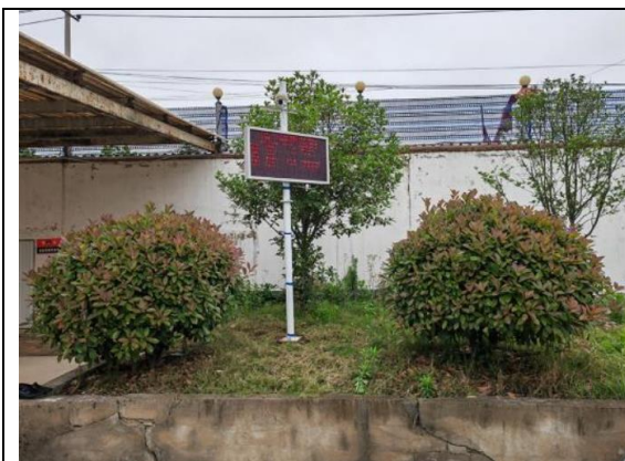
现有厂区 TSP 在线监控设施
