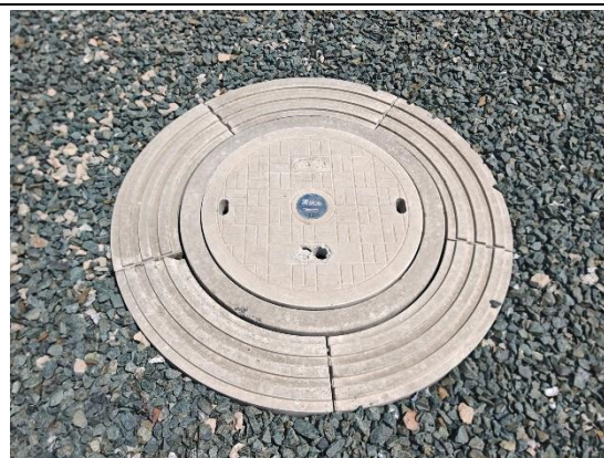
站内现有的事故油池
