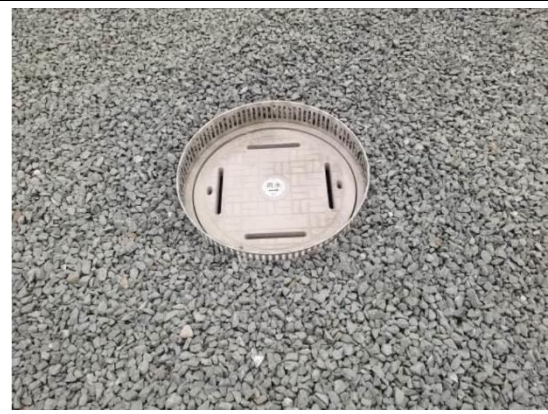
站内雨水收集井
