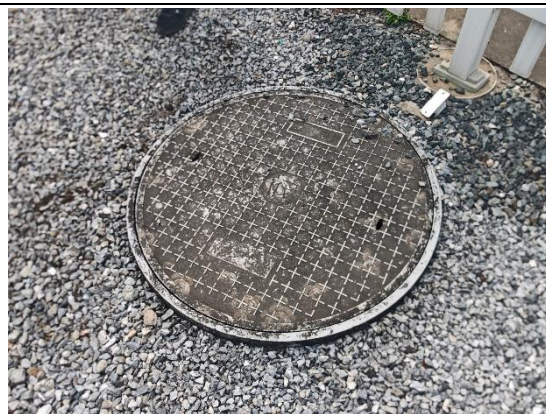
站内现有的事故油池
