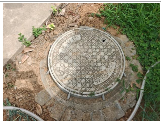
站内现有的化粪池
