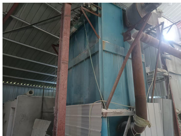
项目现有工程袋式除尘器（1）
