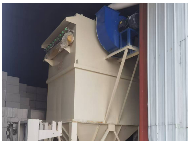
项目现有工程袋式除尘器（2）
