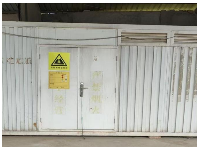
危险废物暂存间
