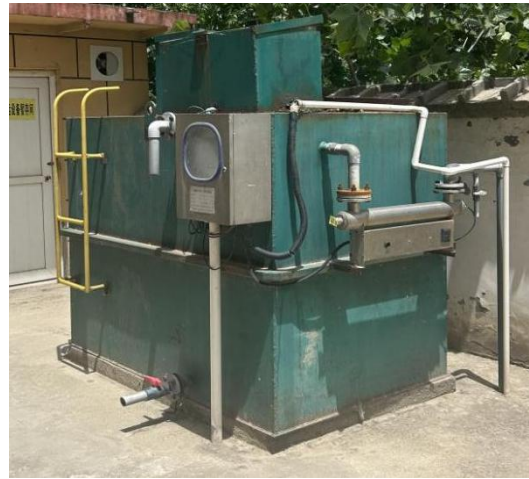
项目已建污水处理站现状
