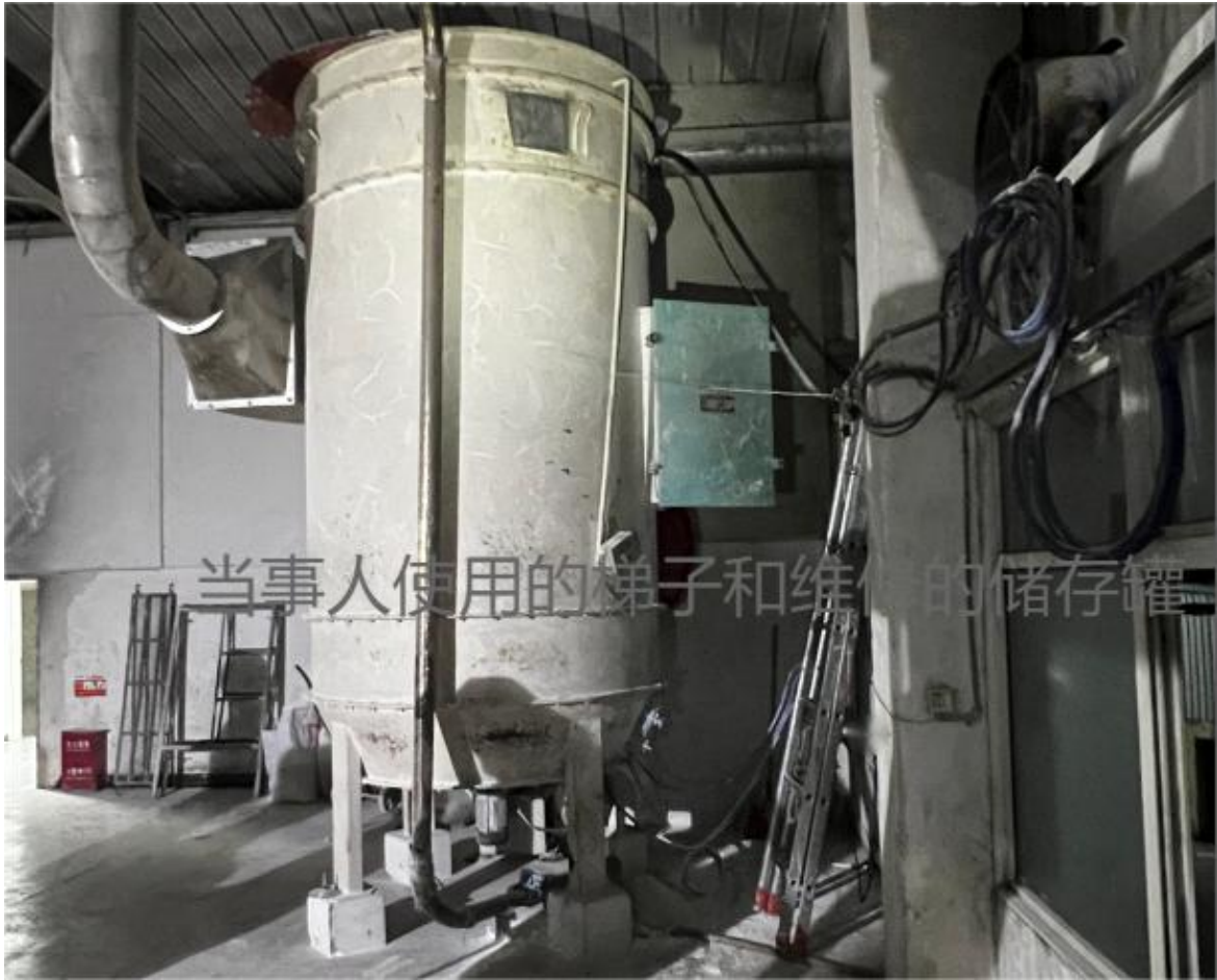
图1 面粉风送储料罐
