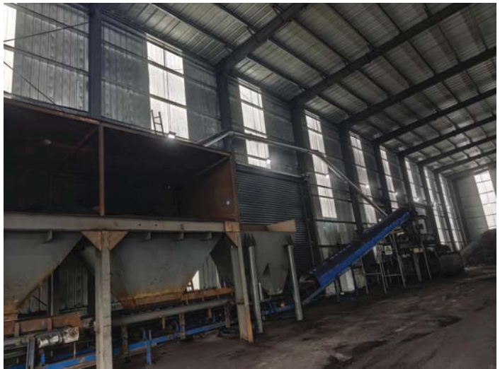
炼铁除尘灰车间上料口集尘罩及废气收集管道
