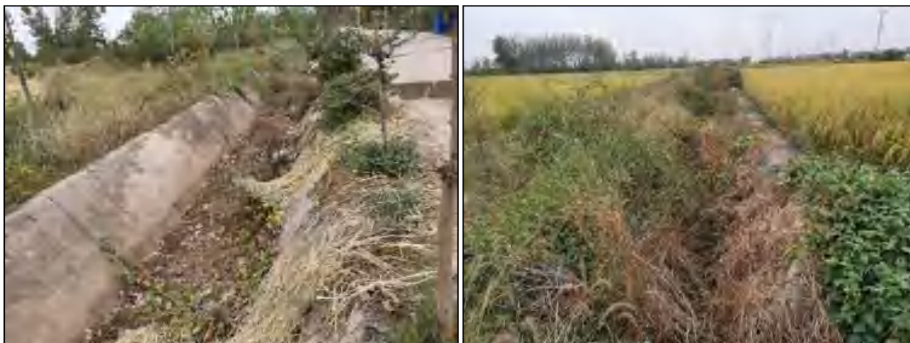
图 2.2-4 任大寨支渠渠道淤积现状照片
