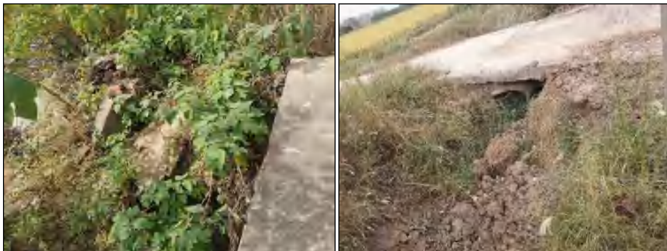
图 2.2-6 现状斗门、过路涵损毁照片
