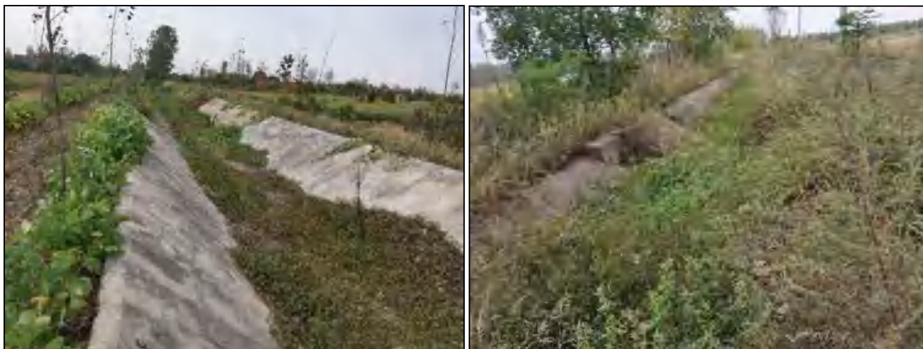
图 2.2-3 任大寨干渠渠道淤积现状照片
