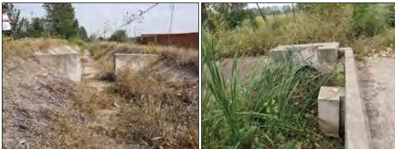
图 2.2-7 现状斗门、节制闸无闸门及计量设施
