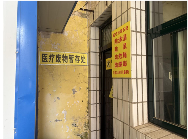
现有医疗废物暂存间
